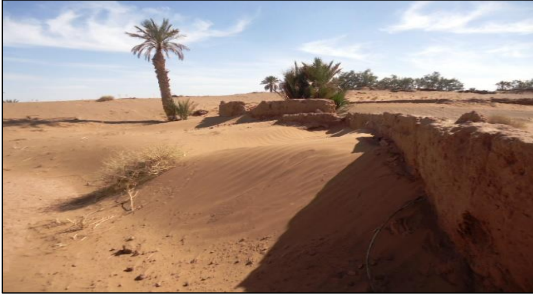
صورة رقم 16 : سور تضرر بفعل زحف الرمال بمنطقة تنغراس (الريصاني)
